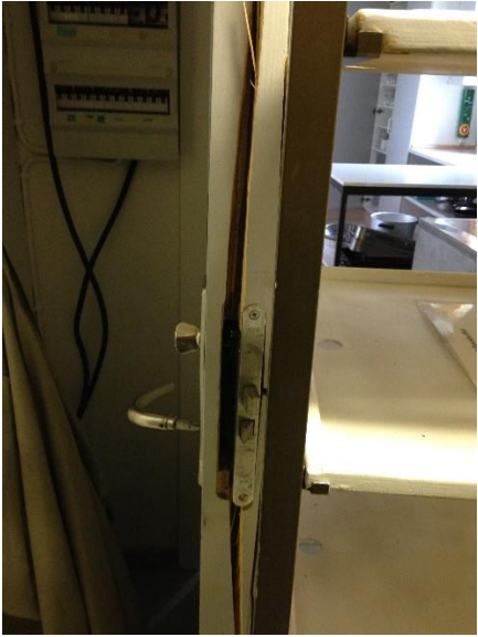
Beskadiget dør til vort depotrum.
